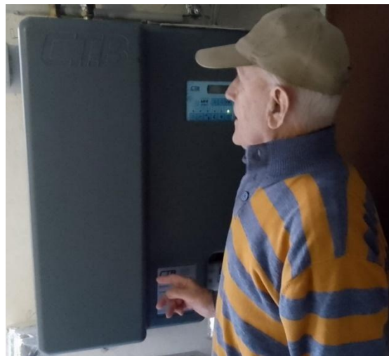
Günther Szedenik vor der Fernwärme-Übergabestation © P.Fellinger
