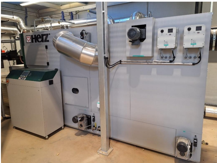
Der 500-kW-Heizkessel BioFire sorgt für Wärme in den Haushalten ©D. Berlakovich
